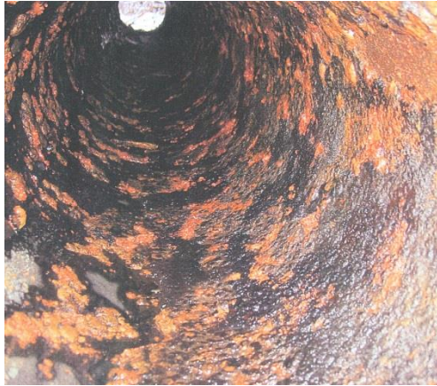
DN 250 grått støpjern mellom Birkeland og Brekke høydebasseng. Bilde tatt nov 2002.
