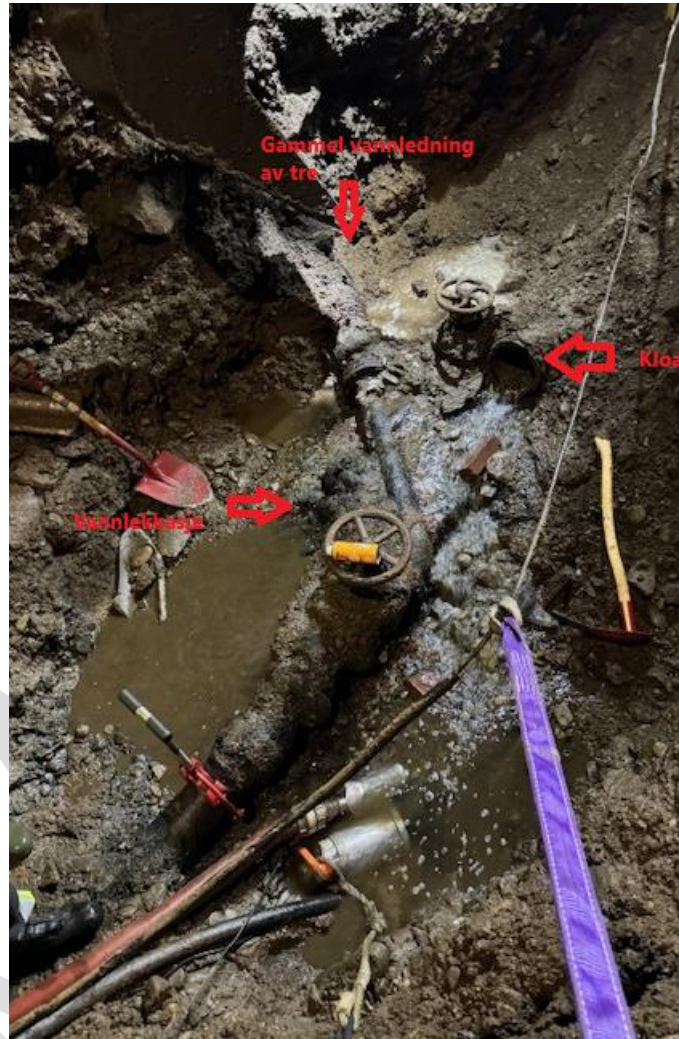
Bildet viser vann og kloakk i vegen utenfor Leabøen barnehage. Dette var en lekkasje reparasjon i oktober 2024. Her ser vi 100 år gammelt rørarbeid, der vannledninger av grått støypejern går inn på en tre-ledning. Kloakkrøret ligger rett oppå vannledningen.
