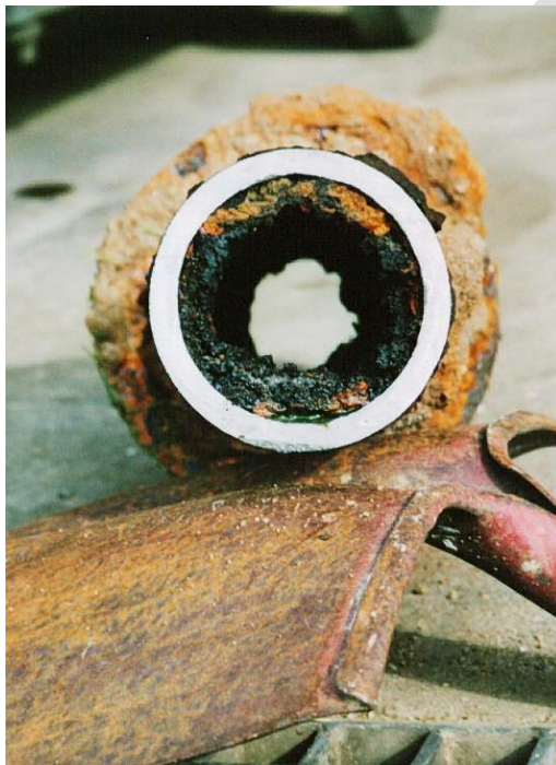
DN100 grått støpjern, bilde tatt juni 2001 fra Rabbane/Saudasjøen. Her ser vi at tykkelsen på godset i røret er bra, men at kapasiteten til vannleveransen er svært begrenset. Tverrsnittet i røret er her under 1/3 av det som det skal være.
