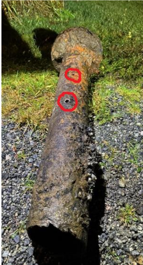
Bildet viser ett rør med vannlekkasje fra en reparasjon utenfor Leabøen barnehage oktober 2024. Godset i røret er blitt svært tynt og det hadde oppstått flere lekkasjer her.
